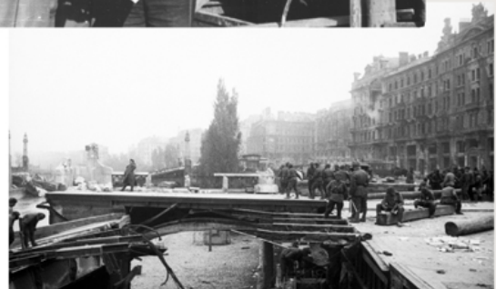
Sowjetische Mineure beschäftigen sich mit der Rekonstruktion einer zerstörten Brücke in Wien. 1945 Sammlung der Russischen kriegshistorischen Gesellschaft
